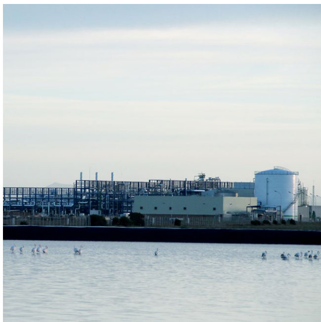
Guzman solar thermal power plant, Palma del Río, Córdoba (Spain).
